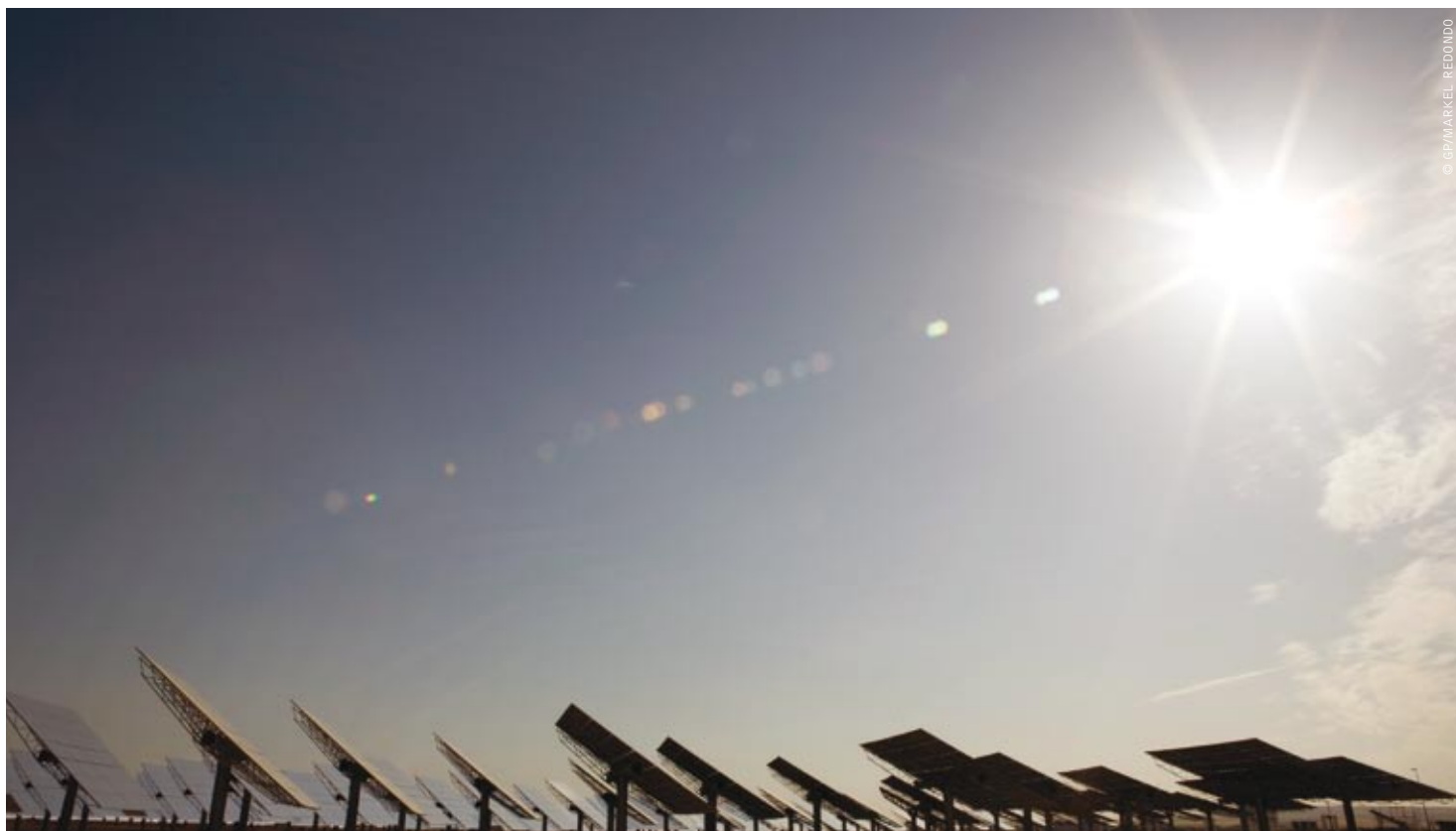
На снимке: СОЛНЕЧНАЯ ТЕРМАЛЬНАЯ ЭЛЕКТРОСТАНЦИЯ БАШЕННОГО ТИПА PS10. 624 ПОДВИЖНЫХ ЗЕРКАЛА КОНЦЕНТРИРУЮТ СОЛНЕЧНЫЕ ЛУЧИ В ВЕРХНЕЙ ЧАСТИ БАШНИ ВЫСОТОЙ 115 М, ГДЕ РАСПОЛОЖЕНЫ ТЕПЛОПРИЕМНИК И ПАРОВАЯ ТУРБИНА. СЕВИЛЬЯ, ИСПАНИЯ.
