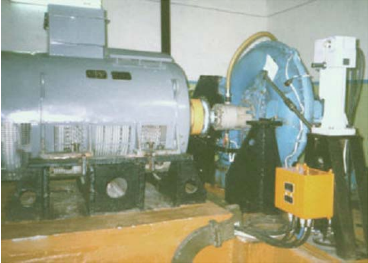
Гидроэнергоагрегат с турбиной ФГ-2. МГЭС №1 г. Северо-Курильск
