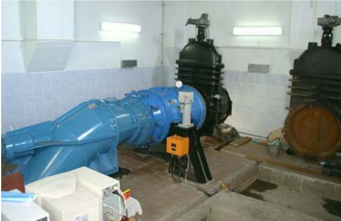
Машинный зал МГЭС «Сурского гидроузла»
